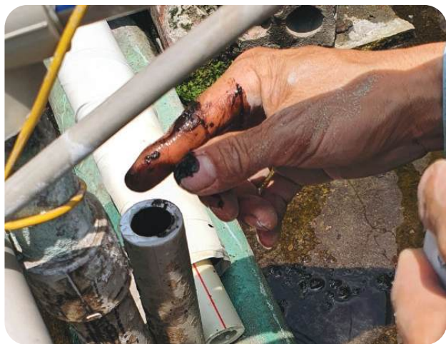
VỠ ĐƯỜNG ỐNG
